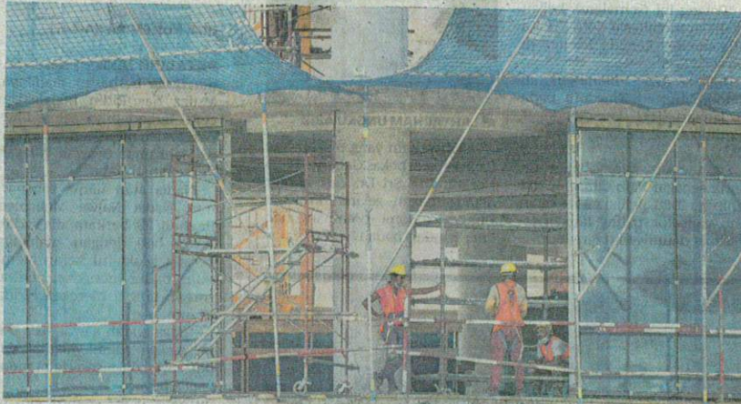
PEKERJA asing sedang menjalankan kerja-kerja pembinaan di Jalan Bukit Pantai semalam. – AMIR KHALID
